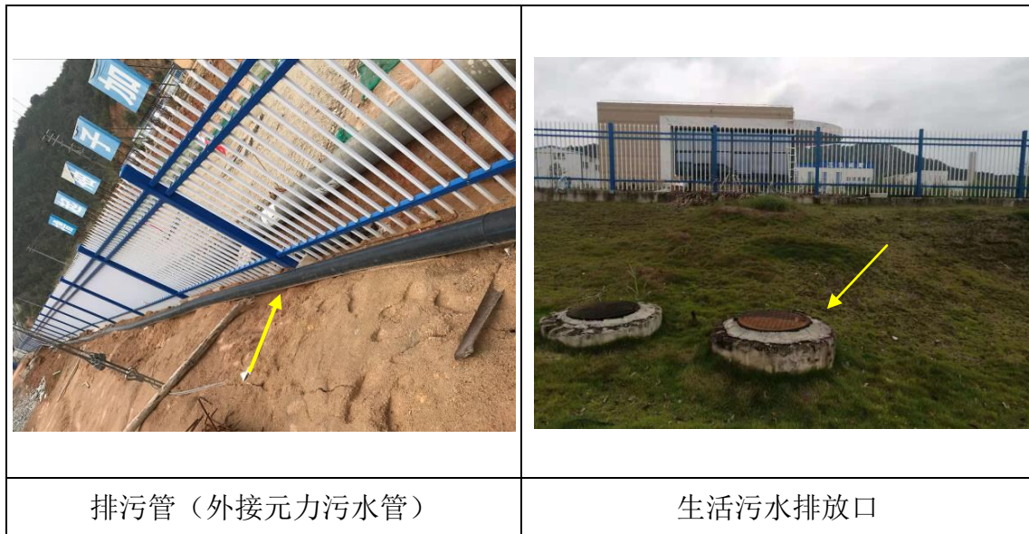
图 4.1-2 废水治理设施现场情况
